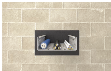
Aplicación en bandeja de cables
