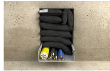
Aplicación eléctrica en pared
