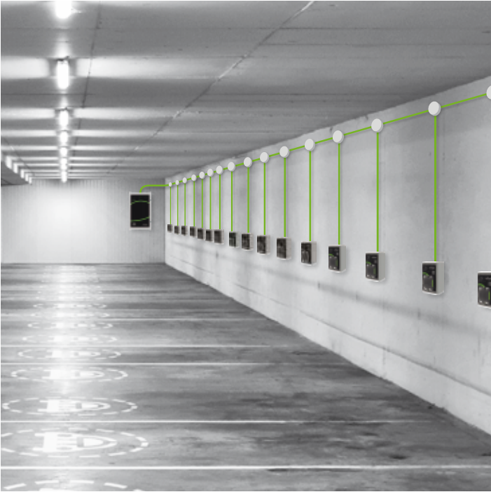
Instalación en parking subterráneo.
