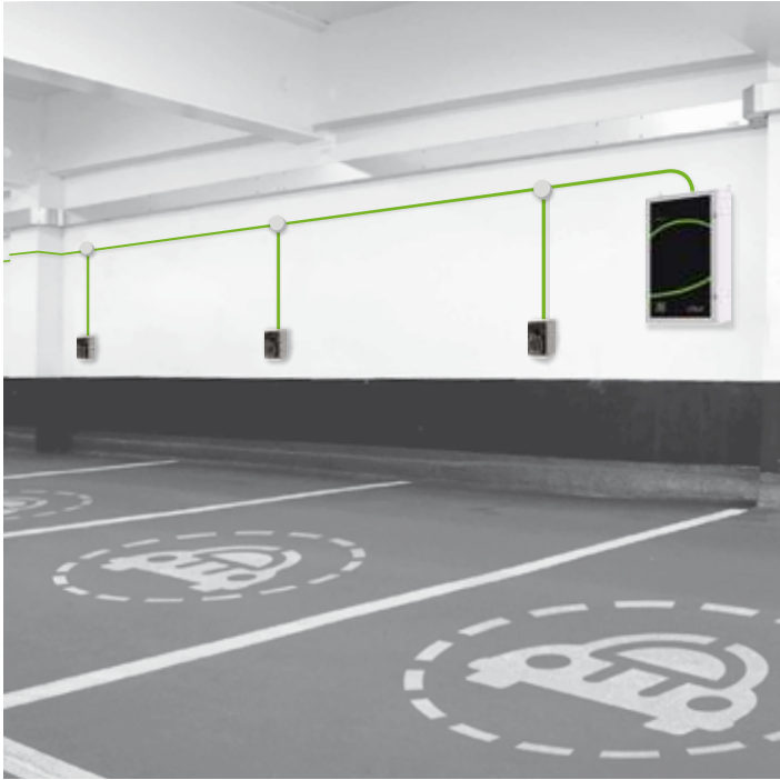
Instalación en nave industrial / centro comercial.
